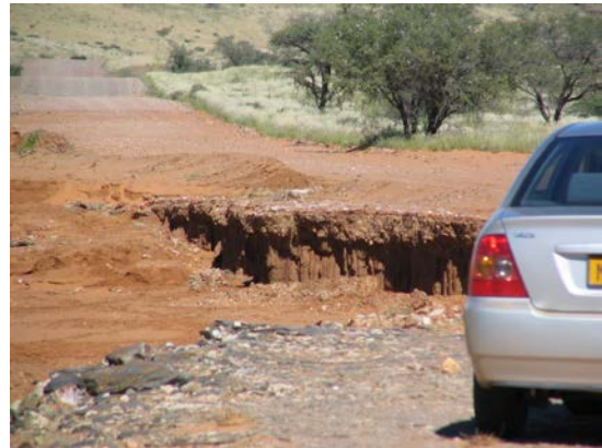
Abb. 2: Namibische Pad (=Schotter- bzw. Sandpiste) nach der Regenzeit. Ein abkommendes Rivier (=Fluss) hat die Pad fortgespült. - Foto: R. Glawion
