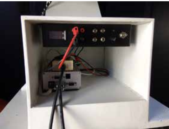
Abb. 2: Das neue Netzteil, mit mehreren 12V Anschlüssen, darunter die FS2
